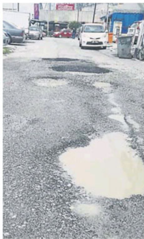
蕉赖 9 英里新村 1 路坑洞处处。
